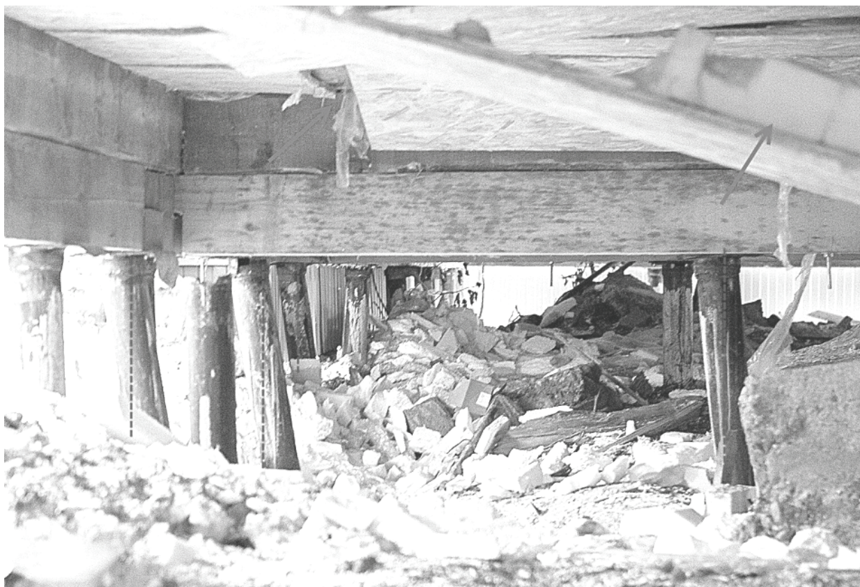
Рисунок 1. Отклонения отдельных стальных буровинтовых свай от вертикали превышают 15^\circ , что недопустимо. Выявлено локальное отслоение OSB-плит цокольного перекрытия (указано красной стрелкой), отсутствие гидроизоляции OSB-плит и нарушение целостности слоя теплоизоляции. Наличие строительного мусора затрудняет вентиляцию, что способствует развитию опасных дереворазрушающих грибов.
