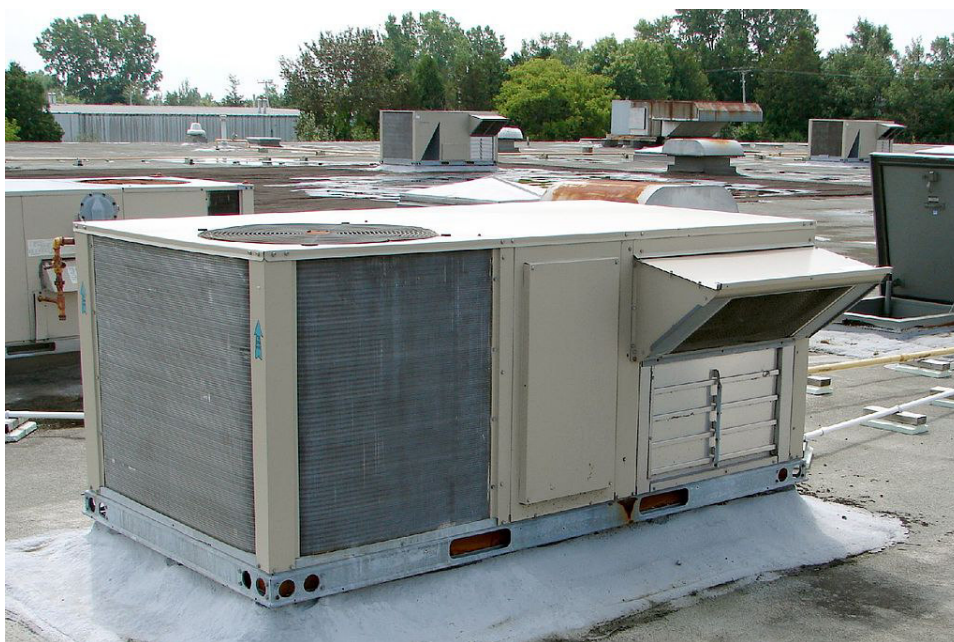
Рис. 2. Системи клімат-контролю на даху будівлі
