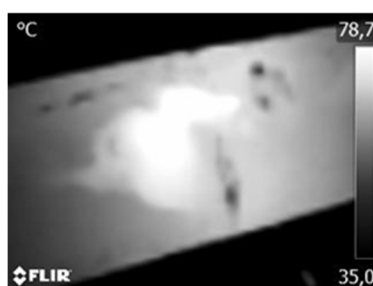
Рис. 6. Термограма зони локального перегріву викликаного карманом що утворився через відшарування шару фарби від поверхні сталевій конструкції
