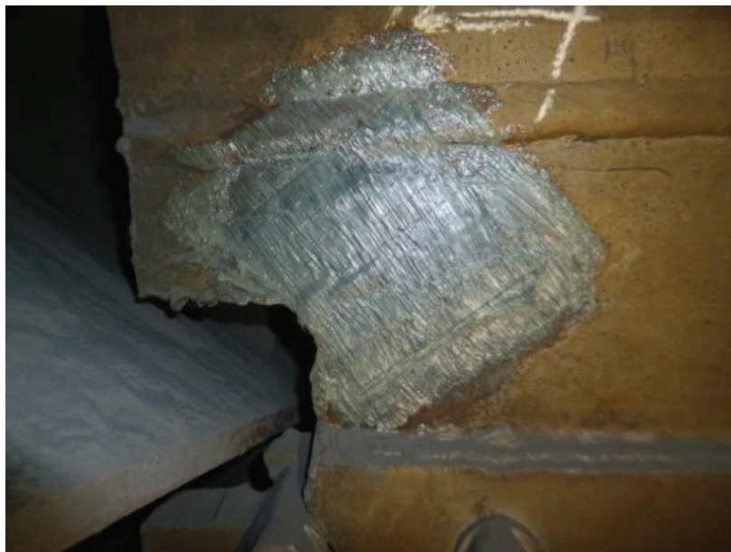
Рис.8 Відремонтована тріщина в корпусі бункера методом консервації
